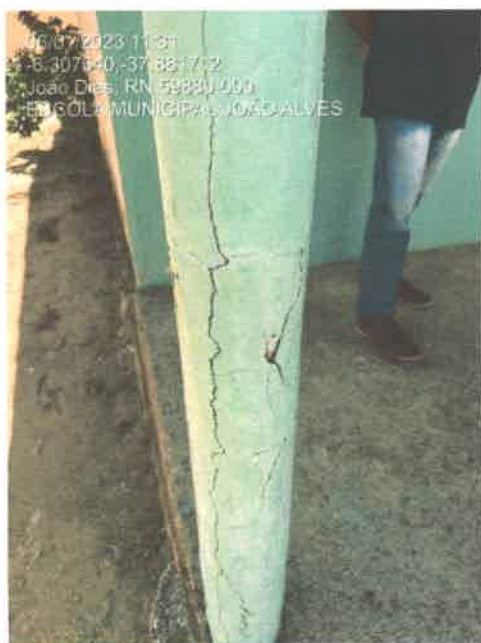
Figura 2a: Pilar externo - fissuras
