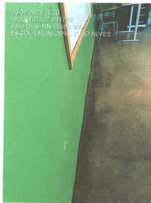
Figura 7b: Deslocamento do piso.
