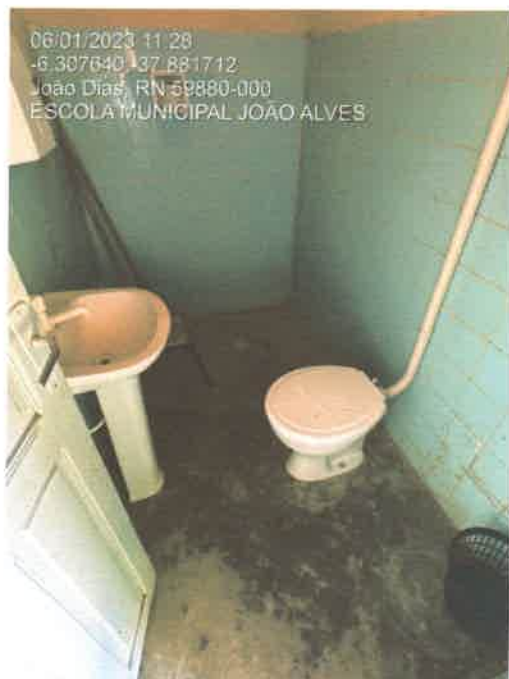
Figura 6c: Piso com fissuração e sem uniformidade.
