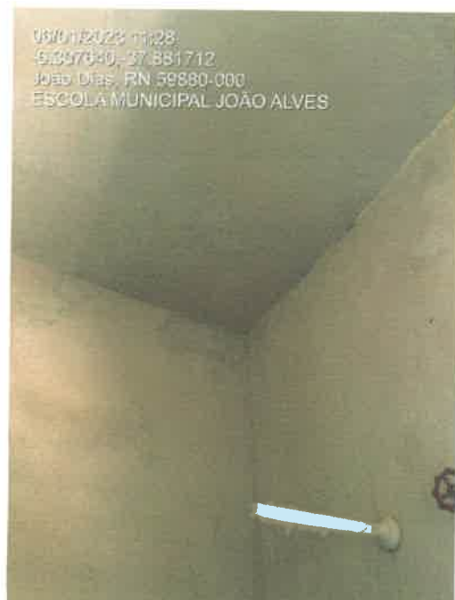
Figura 9a: infiltração do teto para alvenarias.
