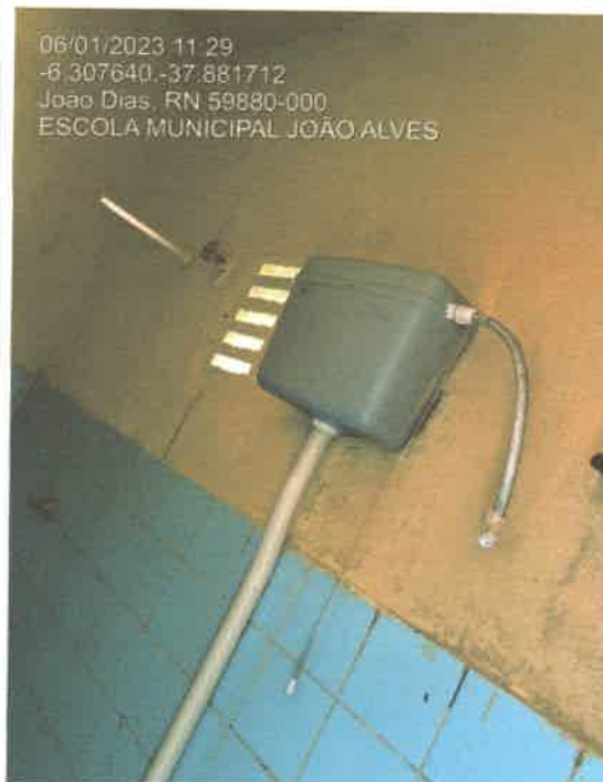
Figura 9b: Equipamento Hidrosanitários quebrados.
