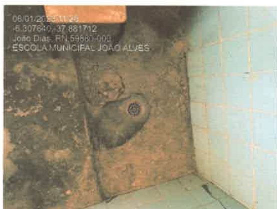
Figura 6a: piso - rachado e com recalque.
